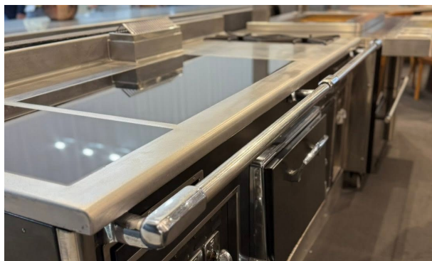
Détail d'une installation de cuisson professionnelle.
